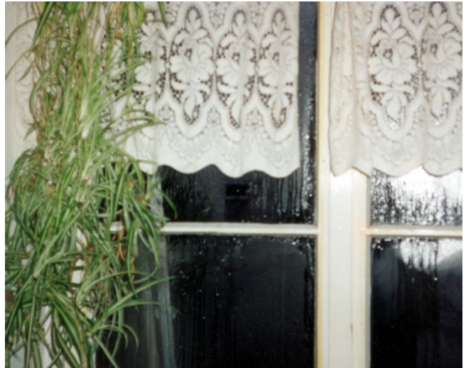
Ablaufendes Kondenswasser an einem einfach verglasten Fenster
